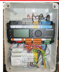
Coffret électrique IP56
