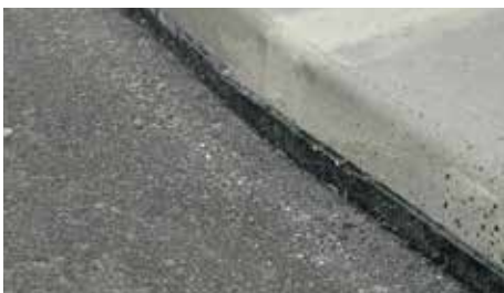
União de betão/asfalto (Stratos R1)
